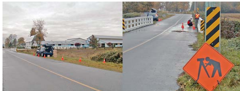
Photo 3. Détournement de la circulation par mesure de sécurité. (Source : Environnement Canada et B.C. Ministry of Water, Land and Air Protection, 2005.)
